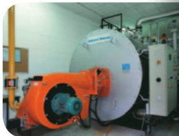
Système de mise en chauffe de l'appareil de production
