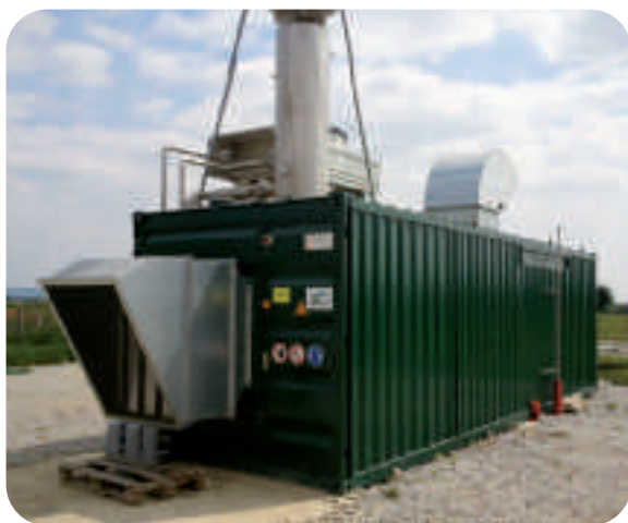
③ Container de cogénération
