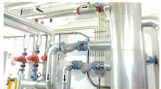
Circuit hydraulique de distribution de la chaleur
