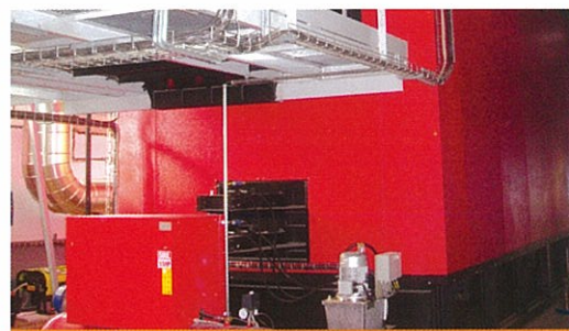
2 chaudières bois 5 MW
